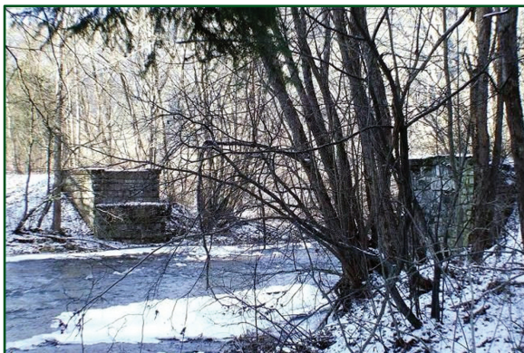
125. Pozostatky mostu ponad Čierny Váh v km 11.7, december 2011
