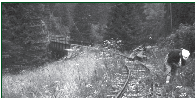
116. Pri moste v km 0.2 odbočky Rovenky, august 1977. Opustená trať začína zarastať
