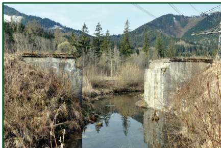
129. Pozostatky mosta v km 15.1, 2012
