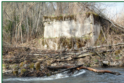
130. Pozostatky mosta v km 15.2, 2012
